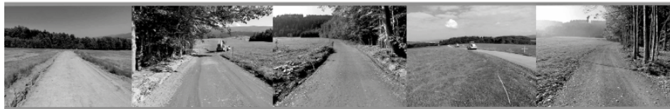
JPÚ Vigantice, lokalita Skalka - vybudování polní cesty z mechanicky zpěvněného kameniva o šířce jízdního pruhu 3 m. Pro příčné odvodnění jsou vybudovány svodnice. Podélné odvodnění bude řešeno odvodňovacím drenem.
